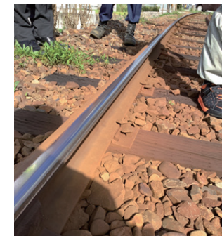
【No.8】 レール摩耗箇所
