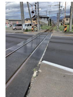
【No.7】 踏切における列車・自動車走行時の動揺箇所
