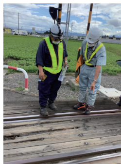
【No.6】 踏切敷板不良箇所
