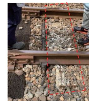
【No.2】PCまくらぎ劣化箇所
