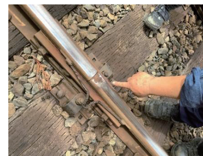
【No.1】レール頭頂面損傷箇所(バッター傷)
