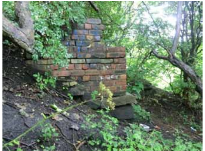
写真⑤ ウォールズエンド・バーンの起点(キリングワース)方のレンガ積橋台はなんとか原形を留めている。
