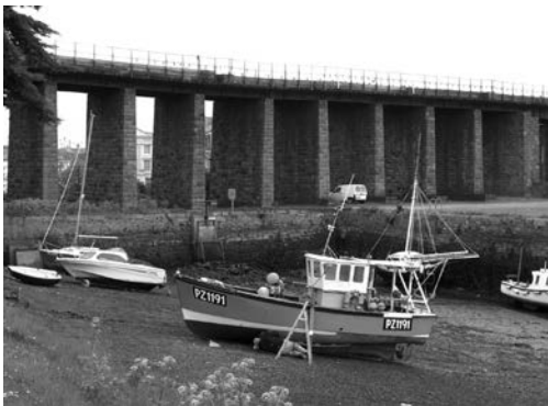
写真-2 ヘイル高架橋。北側にある船溜まりから見る。右がペンザンス方。
